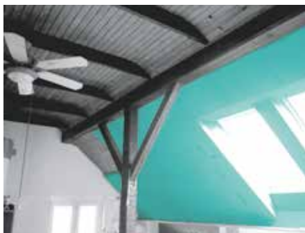
Realizace tepelné izolace pomocí FIBRANxps ETICS , kterou povrchově chráníme vrstvami tenkovrstvé fasády a nátěrem.
