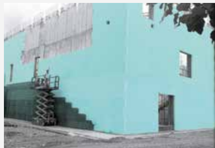
FIBRANxps MAESTRO jako sendvičová izolace; fáze realizace vnější části fasády z pohledového bílého betonu.
