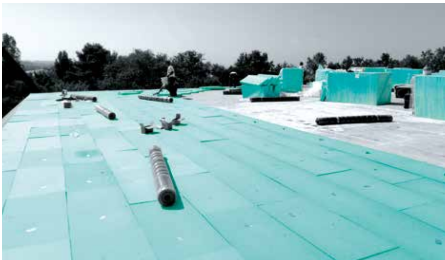
Zvýšení skonu střechy objektu pomocí FIBRANxps INCLINE a současně tepelná sanace rovné střechy.
